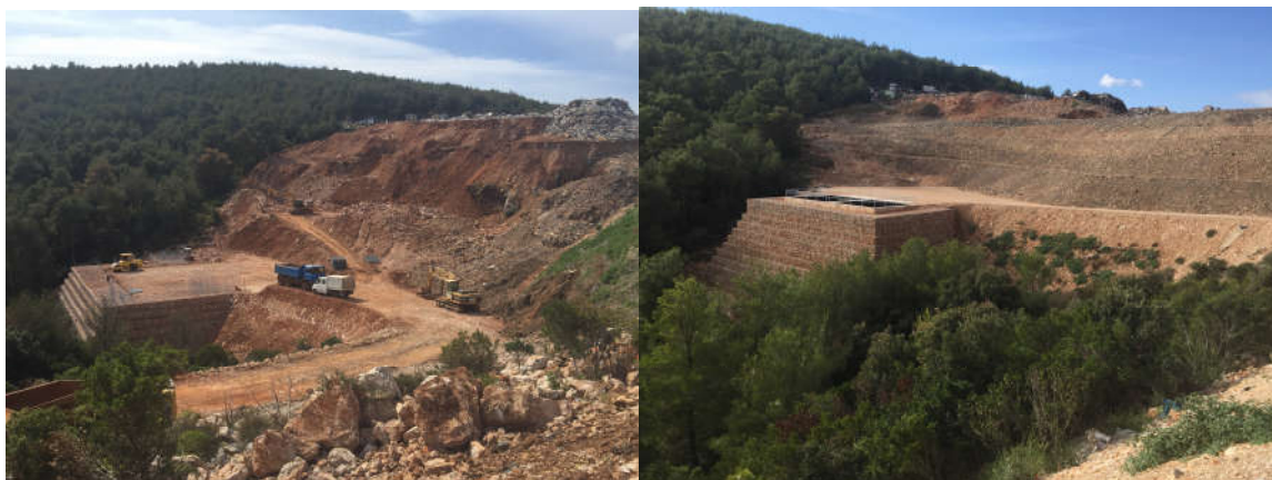
Slika 2. Radovi na odlagalištu Prapatna, Jelsa - formiranje potpornog gabionskog zida prostora s bazenima, ožujak 2017.g. i izvedeni radovi dijela prve faze, studeni 2017.godine (desno).
